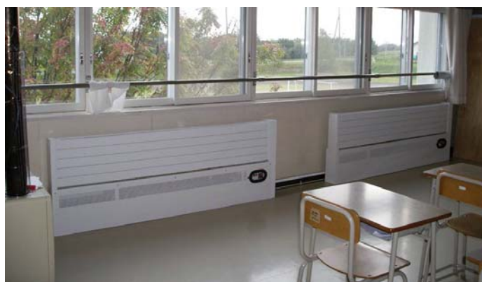
図4 F F式真空パネル暖房機のフィールド試験状況
