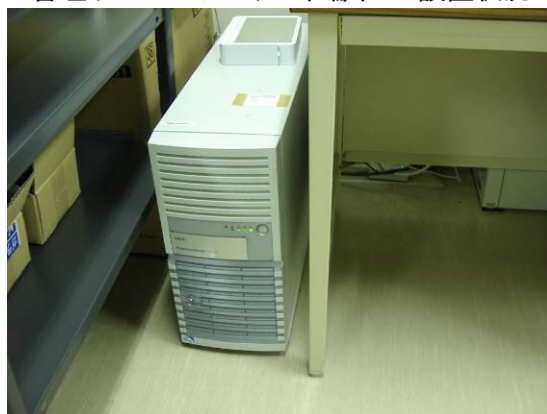
管理サーバー本体設置状況
