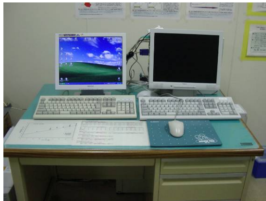
管理サーバーシステム、端末PC設置状況
